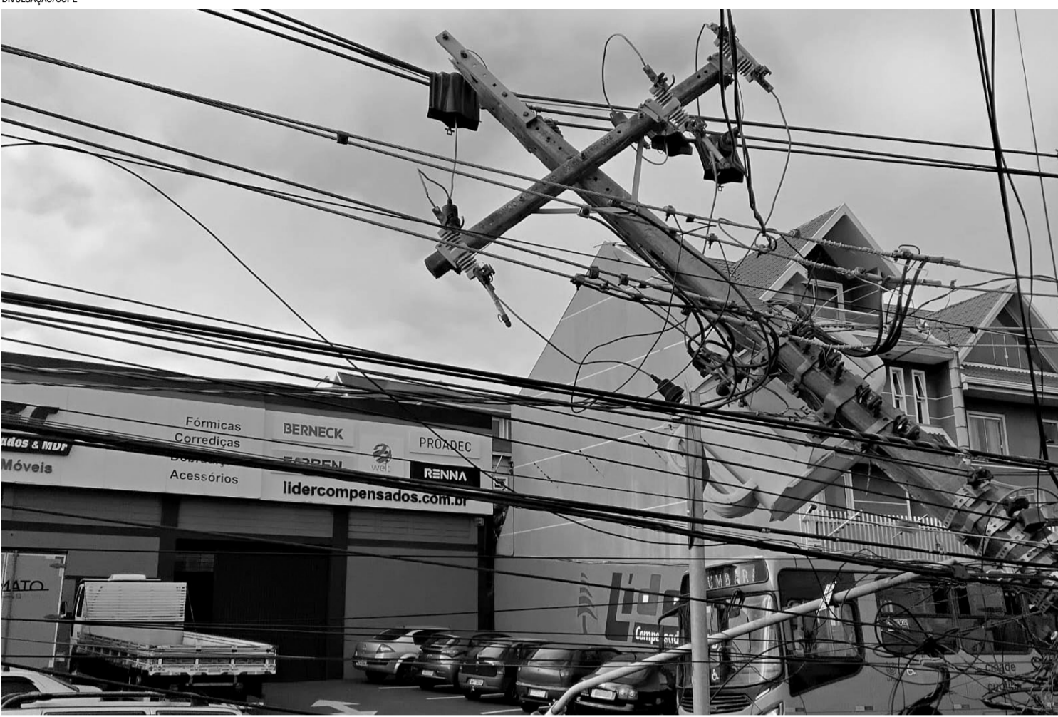
Quebras de postes por abaloamento estão entre os danos causados por terceiros à rede elétrica passíveis de indenização financeira à Copel
